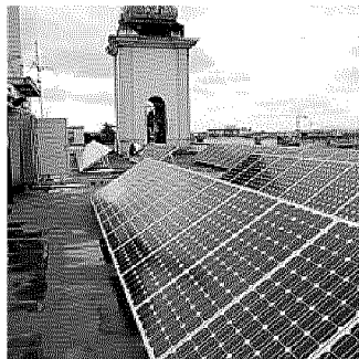
Pannelli solari su un tetto
